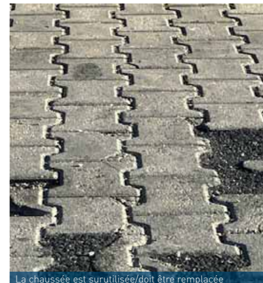
La chaussée est surutilisée/doit être remplacée
