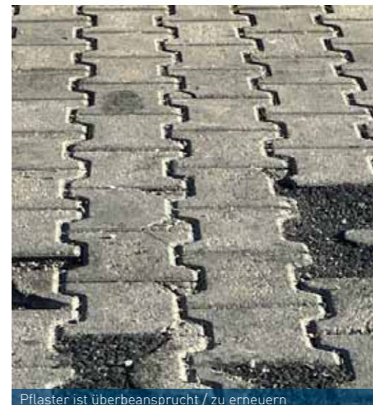
Pflaster ist überbeansprucht / zu erneuern
